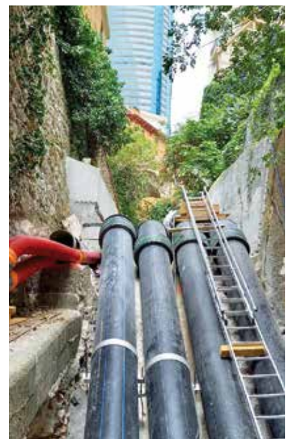
Die PE-Leitung zum weiteren Transport der Wärme-/Kälteenergie
